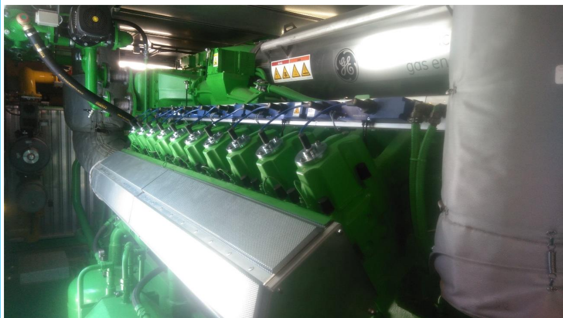
トーヨーバイオメタンガス発電所内部 2019年6月撮影
