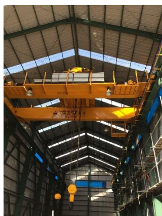
発電機室内に設置が完了した EOT (Electric Overhead Traveling) クレーン
